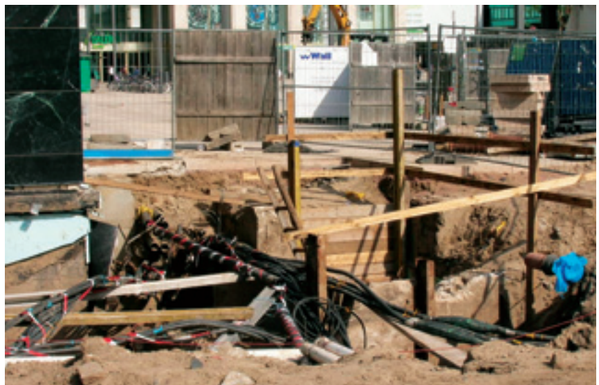
Abb. 1 Beispiel einer innerstädtischen Kabelbelegung (Berlin-Mitte)
